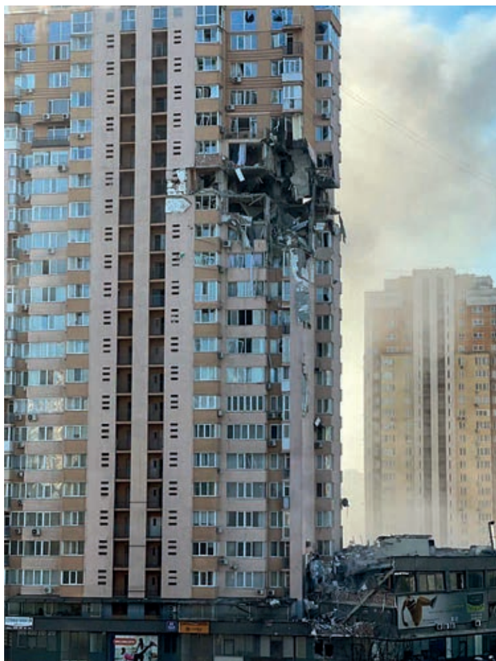
OSTRZELANY BUDYNEK MIESZKALNY W KIJOWIE
